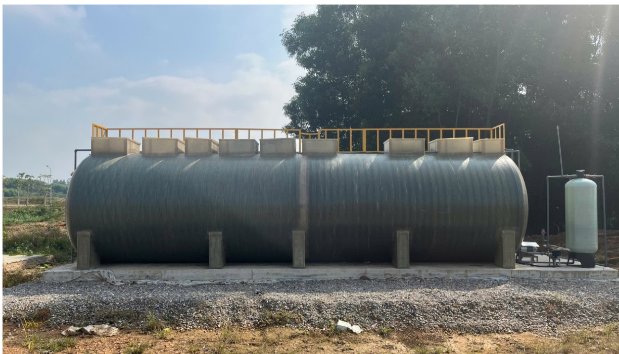
Hình 3.5: Trạm xử lý nước thải công suất 220m 3 /ngày.đêm
