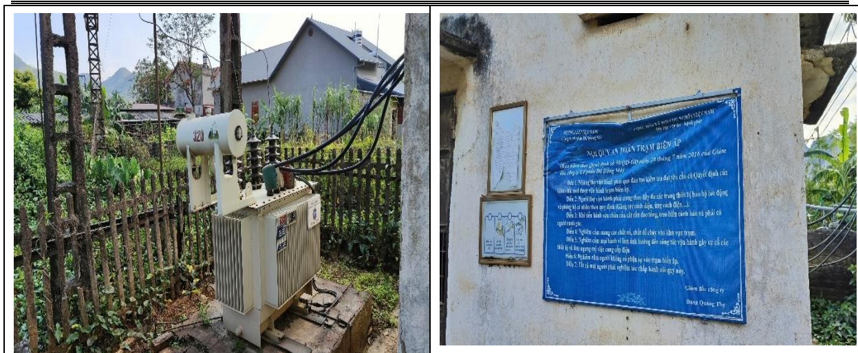
Hình 1.2: Hình ảnh trạm biến áp phục vụ sản xuất của mỏ
