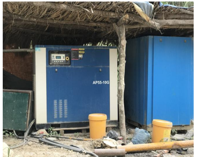
d) Trạm máy nén khí
