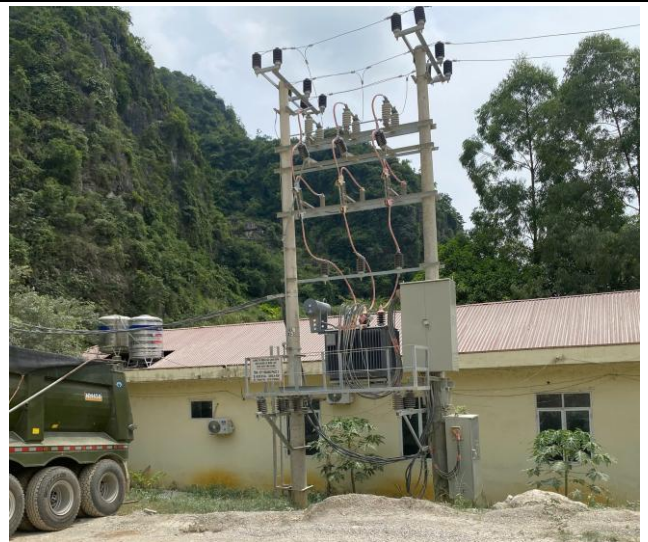
b) Trạm biến áp
