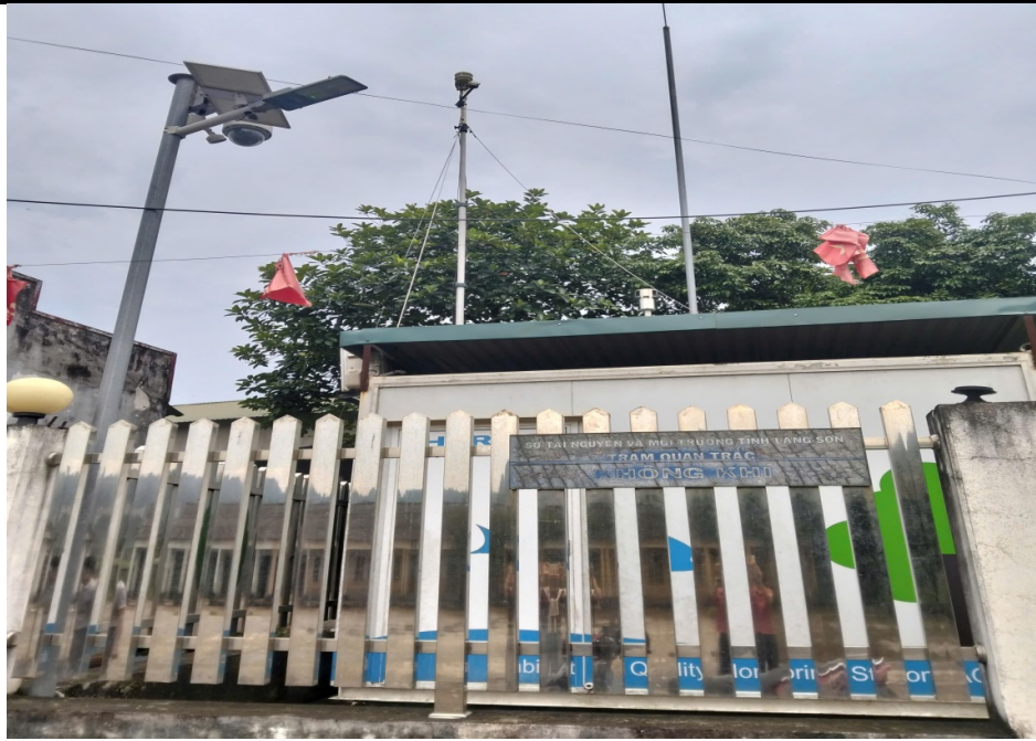
Hình 2. 14. Trạm quan trắc tự động xã Hữu Lũng
