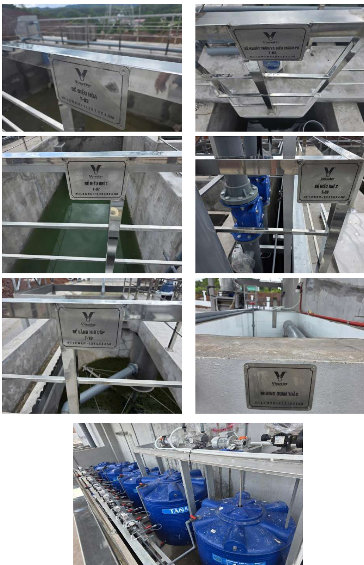
Hình 3.8. Một số hình ảnh hệ thống xử lý nước thải tập trung CCN Đình Lập
